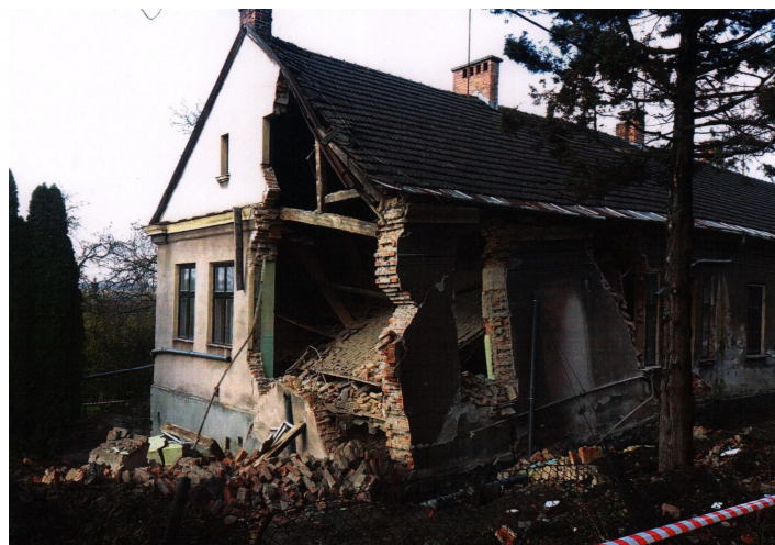
Fot. 5. Widok narożnika południowo-wschodniego zaraz po awarii budynku.
