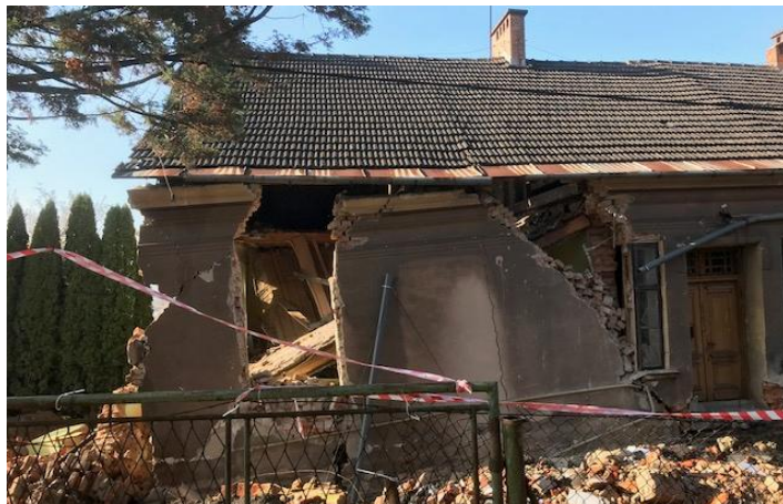
Fot. 3. Widok budynku po częściowym zawaleniu.
