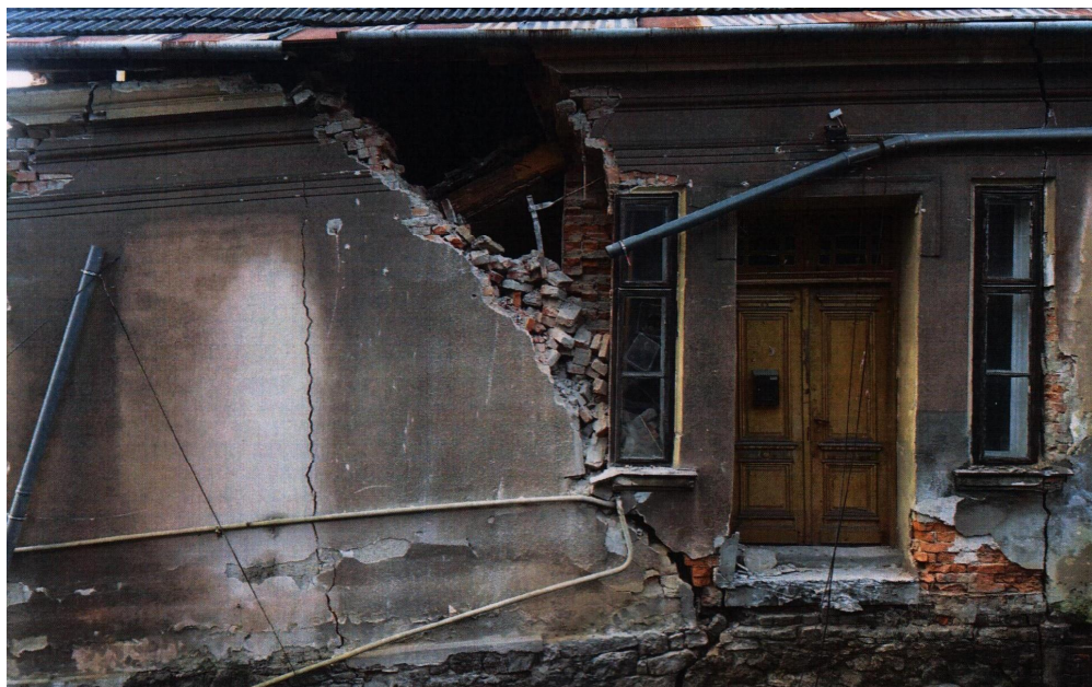
Fot. 6. Widok budynku od strony wschodniej po awarii.
